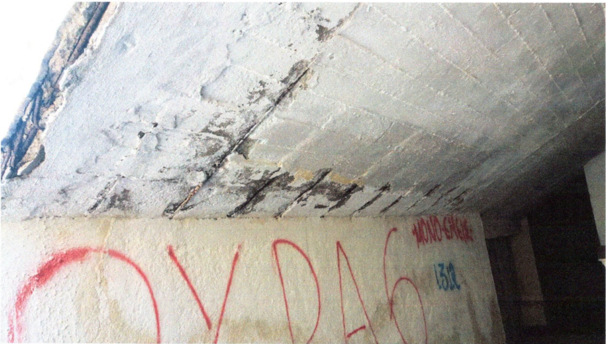
Εικ. 07. Η κερκίδα εσωτερικά της δυτικής εισόδου (ό.π.) Διακρίνεται το σημείο η διάβρωσης του οπλισμού και η ενανθράκωση του σκυροδέματος που θα επισκευασθεί.
