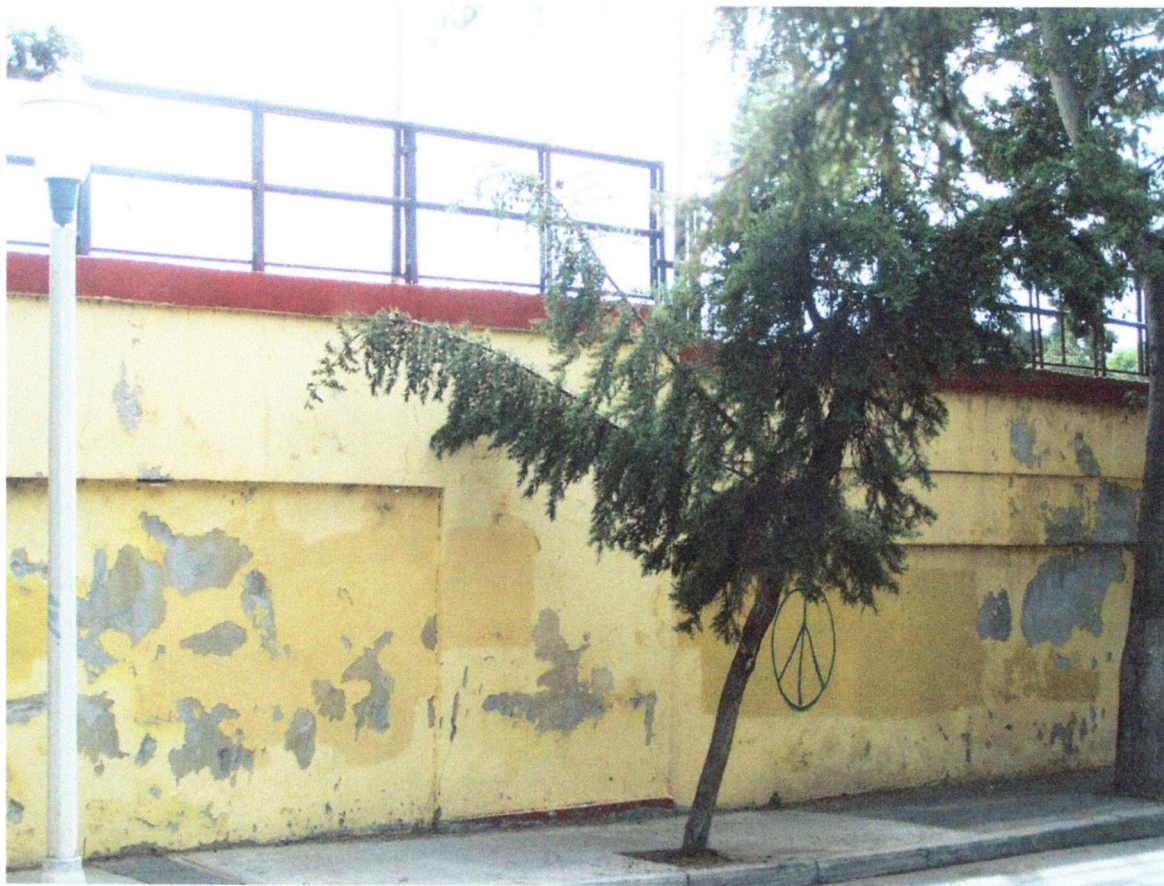
Εικ. 09. Φθορές επιχρισμάτων , αποφλοίωση χρωματισμών του περιμετρικού τοίχου
