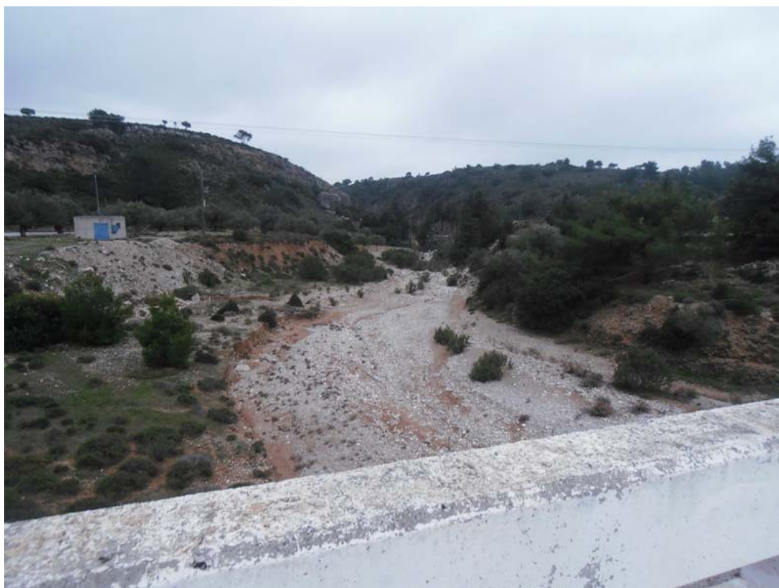
Φωτο 23: Κοίτη κλάδου υδρογραφικού δικτύου στη θέση γέφυρας στην Επαρχιακή Οδό Αφάντου - Ψίνθος.
