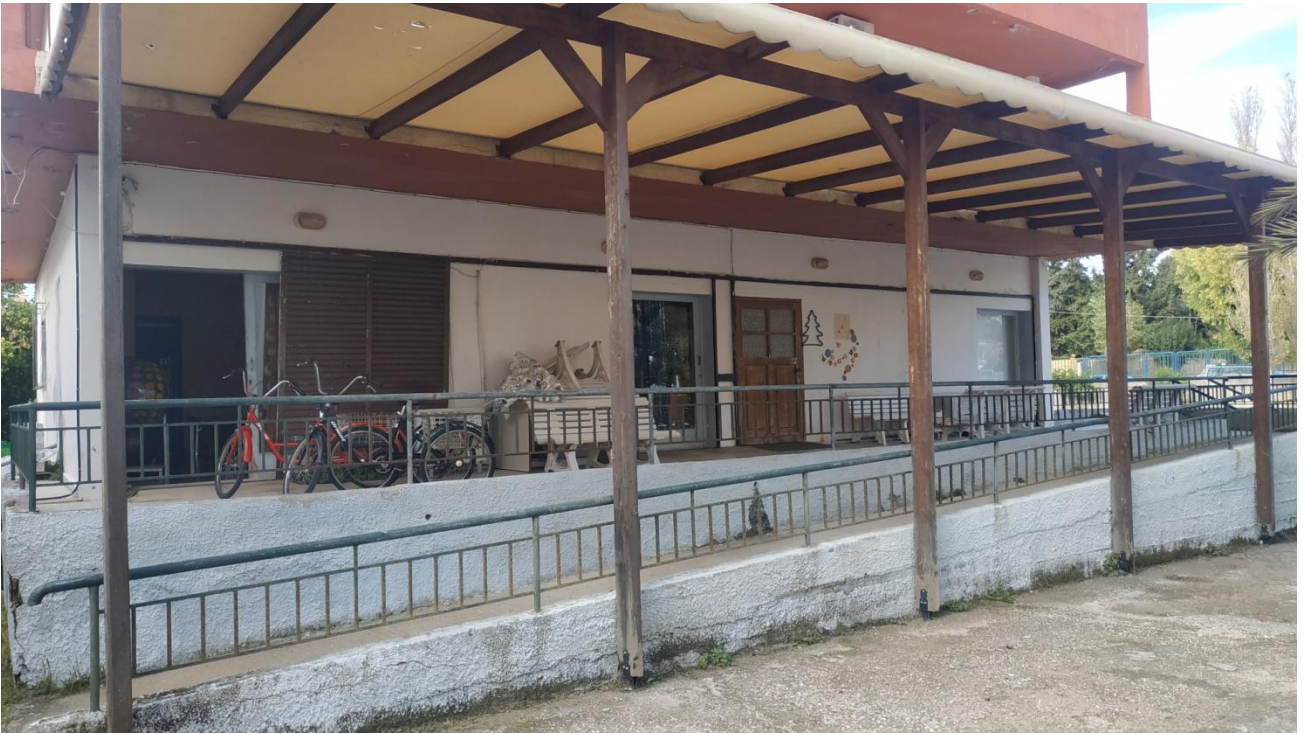
Φ7: Ξύλινη πέργκολα με εμφανή την κακή κατάσταση στην οποία βρίσκεται.
