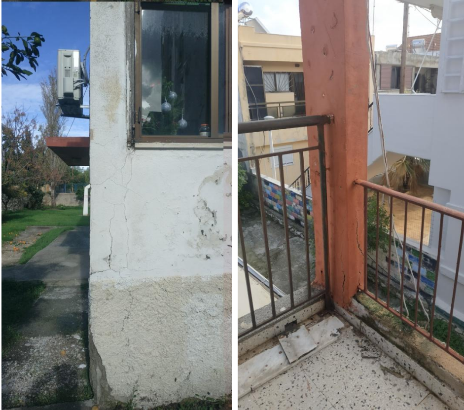
Φ3, Φ4: Ρηγματώσεις στοιχείων οπλισμένου σκυροδέματος
