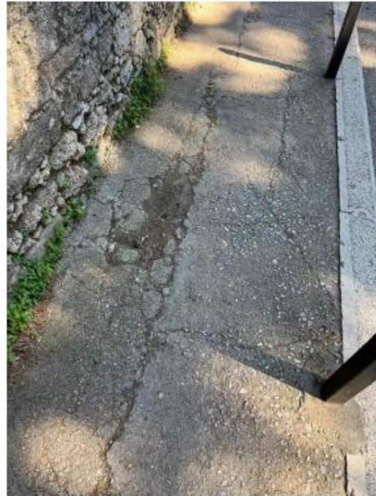
Φθορές υφιστάμενου πεζοδρομίου
